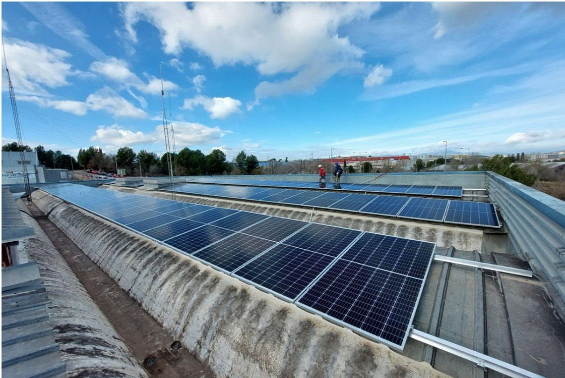
Els panells solars al centre d'operacions d'Agbar a Rubí | Localpres
