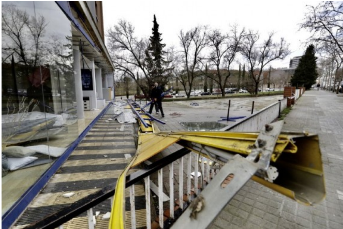
Desperfectes provocats pel vent en una botiga de matalassos a la carretera de Terrassa Foto: Juanma Peláez
