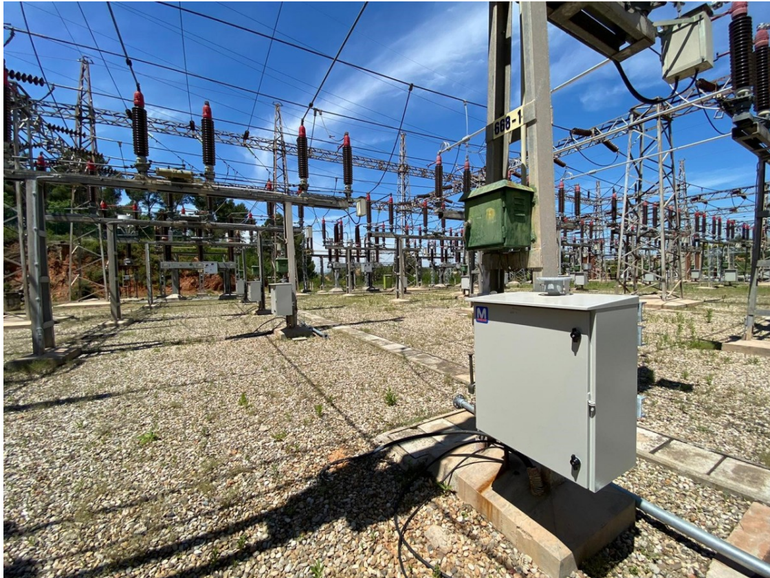
La subestació de Can Jardí de Rubí | Endesa
